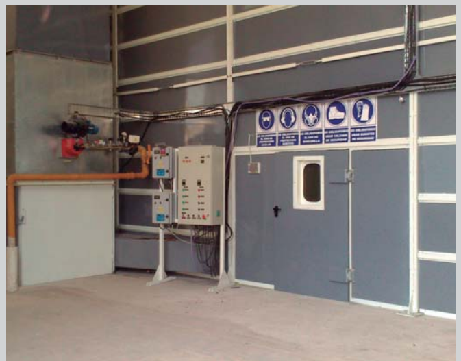
Cabinas de pinturas de automotores y buses.
